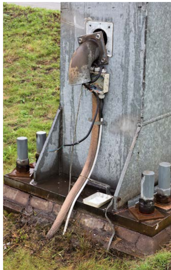
Klettern unnötig: Der Konverter am Sockel kann bequem vom Boden aus gewartet werden.
